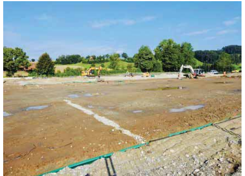
Kunstrasen-Baustelle im Worboden: Hier können erst ab dem 26. September Heimspiele ausgetragen werden. Bild: M. Zurflüh
